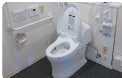
多目的トイレ(橋本支店)
